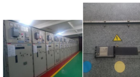
Gambar 26. Implementasi Alat pada Kubikel 20 kV
