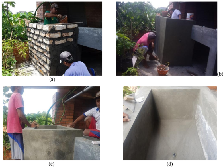
Gambar 6. Pekerjaan bangunan bak koagulasi (a) Pemasangan batu bata dinding, (b) Plester dinding, (c) Penghalusan (aci) dinding, (d) Bangunan bak selesai
